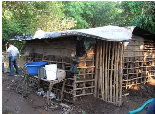
Cocina familiar dañada por la tormenta IDA, con la pérdida de todos los utensilios básicos. En la Colonia El Recuerdo.
